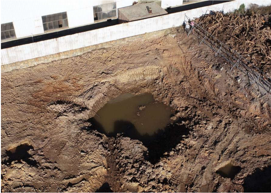
图 2-2 项目区简易雨水收集坑和抽排措施
