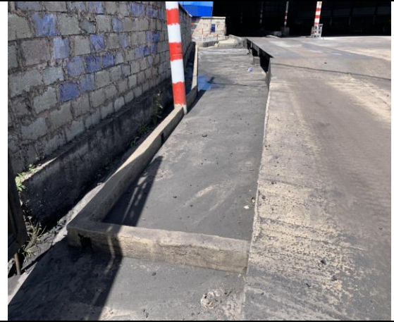
车辆清洁池配备的沉淀池
